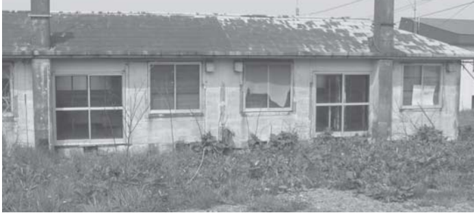
老朽化が進む公共施設
